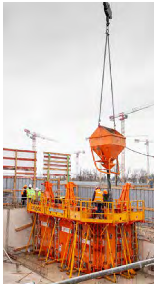
Coulage de voiles en béton très bas carbone Hoffmann Green par temps froid sur le secteur de l'Aire des Vents du Village des Médias
